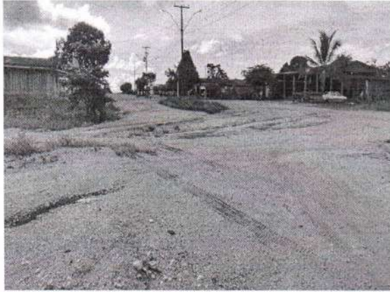
FOTO Nº 01 AV. MUIRAQUITÃ COM RUA SERGIPE (SENTIDO RUA PARANÁ)
